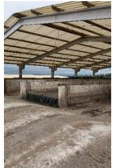
Depósito dos dejetos brutos
