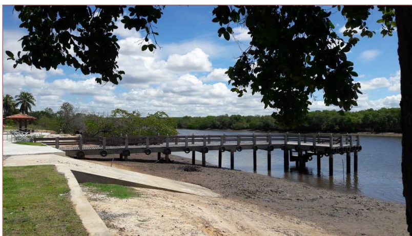
FOTO 7 - Estrutura do píer na reforma do atracadouro do povoado Caibros, em Itaporanga/SE
