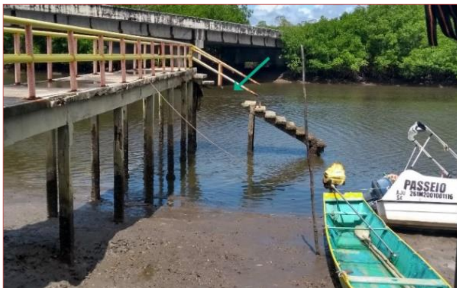
FOTO 2 - Ruptura da escada de acesso ao atracadouro no Porto de N'Angola
